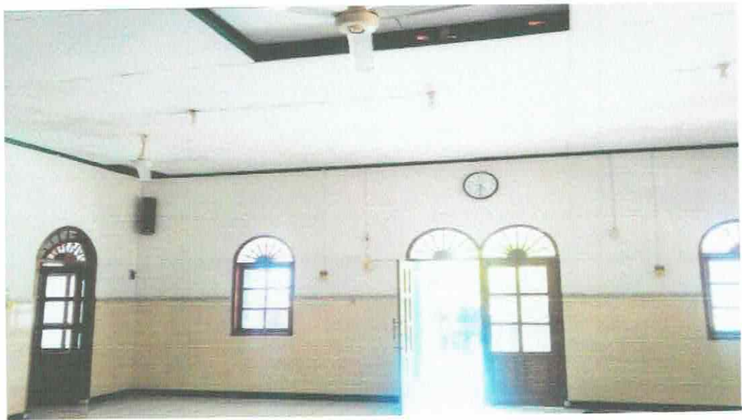
Keadaan Eternit ruang Masjid Asyuhada
